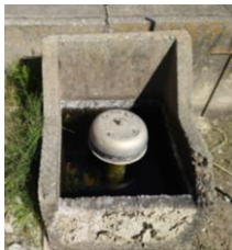
一筆分水栓（給水栓）
