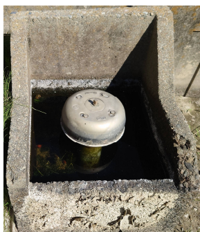
一筆分水栓(給水栓)
