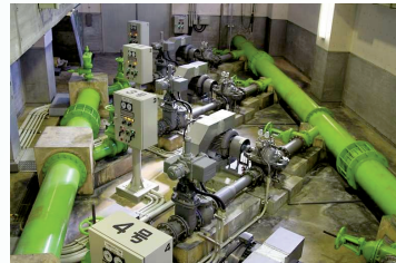
後飛保配水場ポンプ室内
