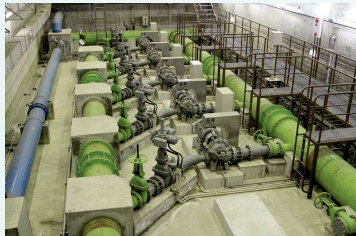
下般若配水場ポンプ室内
