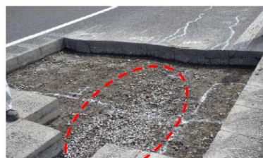
路盤の損傷の例 (路盤の細粒分がポテンピングにより 流失し、碎石が集まっている状況)
